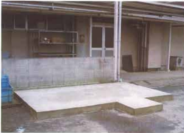
土台ベースはコンクリート 平面であれば特に必要ない
